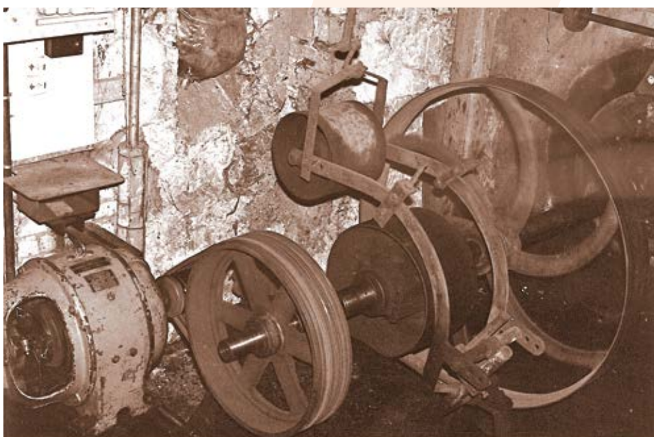
Turbinenwelle mit Schwungrad, 2 Riemenscheiben und Generator (Zustand 1986)
