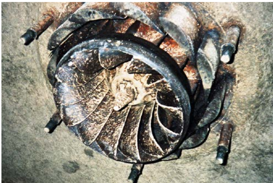
Leitwerk und Wasserrad mit Kalkablagerung (vor Sanierung)
